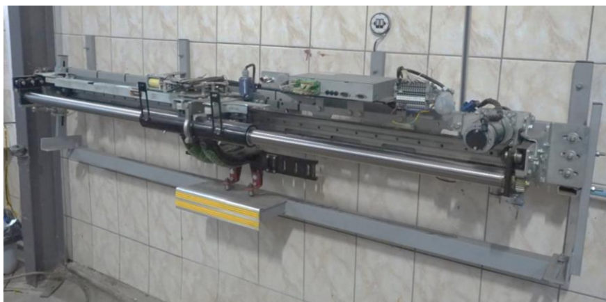
Фото 37. Приводной механизм дверей
