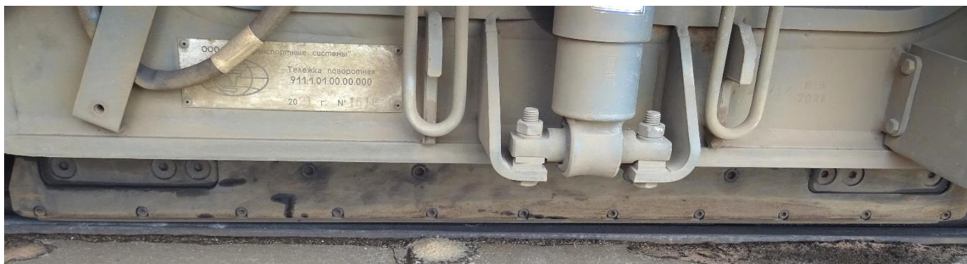
Перекоз рельсового башмака
