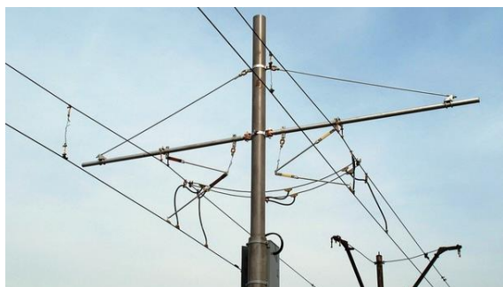
Фото 2. Изоляция контактной сети
