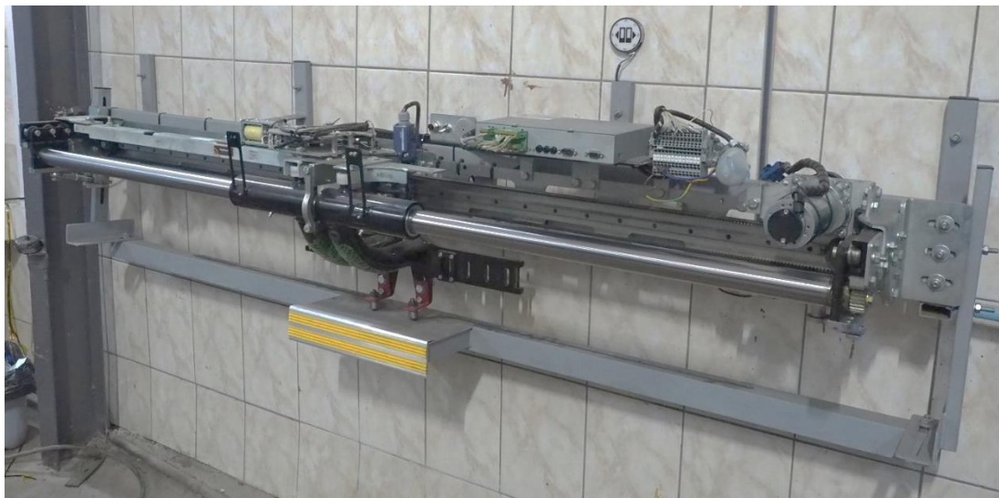
Фото 37. Приводной механизм дверей
